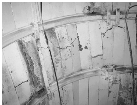
Рис. 1 Состояние крепи камеры ожидания газобезопасности вблизи клетового ствола на горизонте №6 рудника «Интернациональный» АК «Алроса»
